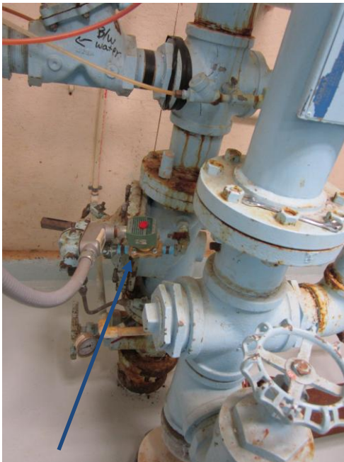
Backwash water PRV
